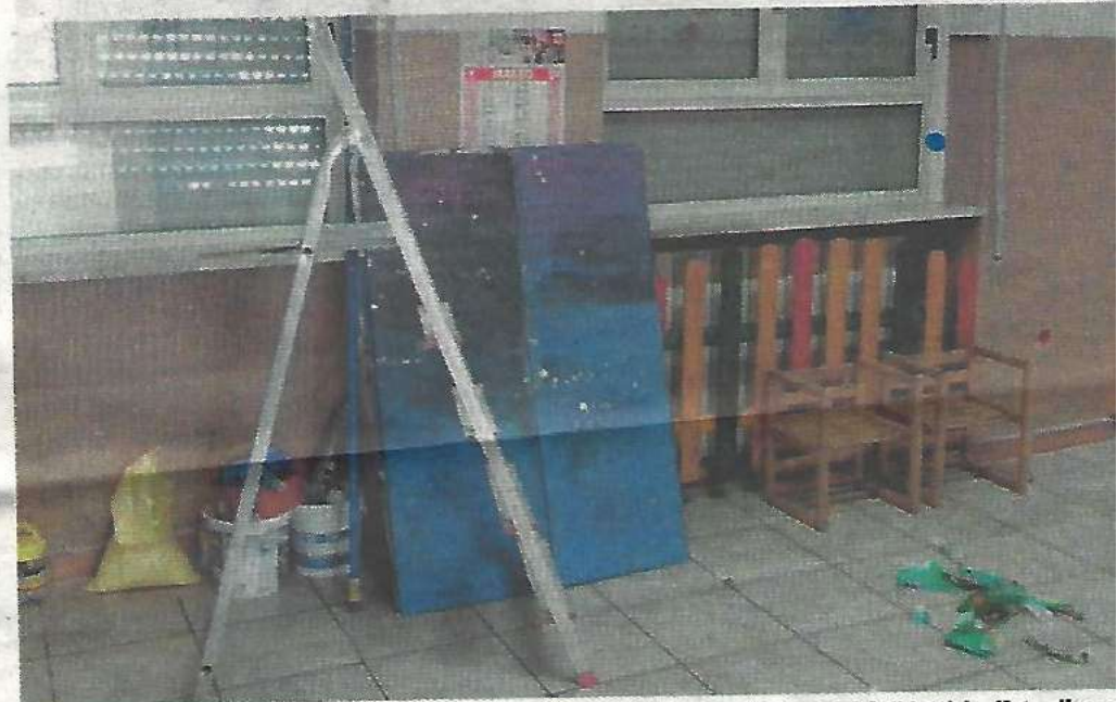
I bidoni di vernice e la scala nell'aula dove erano in corso i lavori nonostante le attività didattiche (foto ellesse
